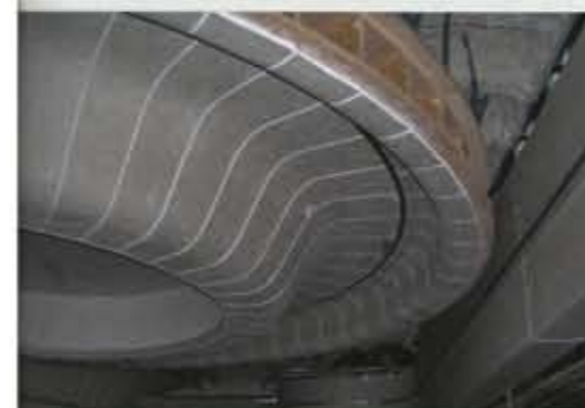
Vorkonfektioniert. Die rund 60 cm hervorstehenden und in Radien zwischen 172 und 198 cm gefertigten Zylinder wurden fast komplett von Knauf vorgefertigt zum Einbauort gebracht.
