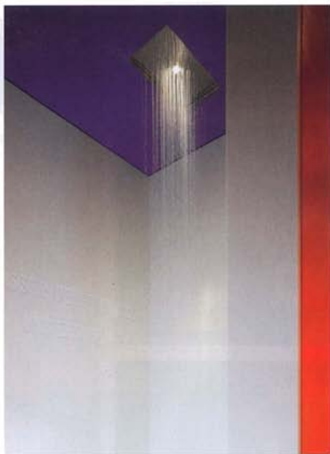
Die Wände der Dusche sind mit Mineralwerkstoff verkleidet, in den Zitate eingegräst sind. Decke mit beleuchteter Regendusche
