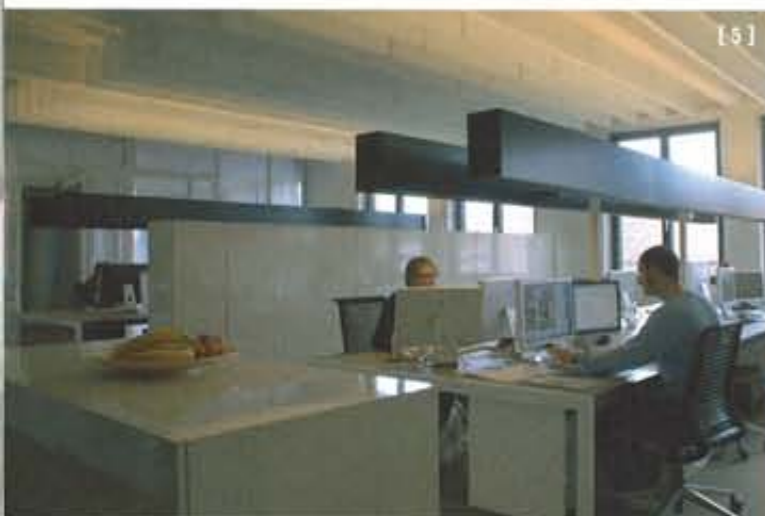
[5] Gruppenbüro mit Lärmschutzdecke und Beleuchtungselementen
